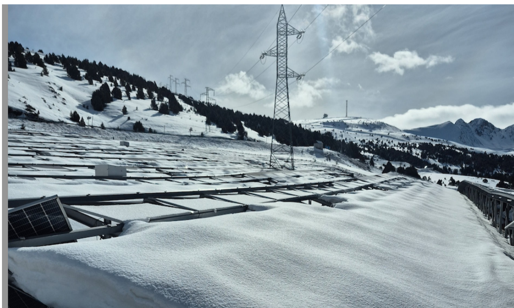
El parc fotovoltaic de Grau Roig ple de neu.
