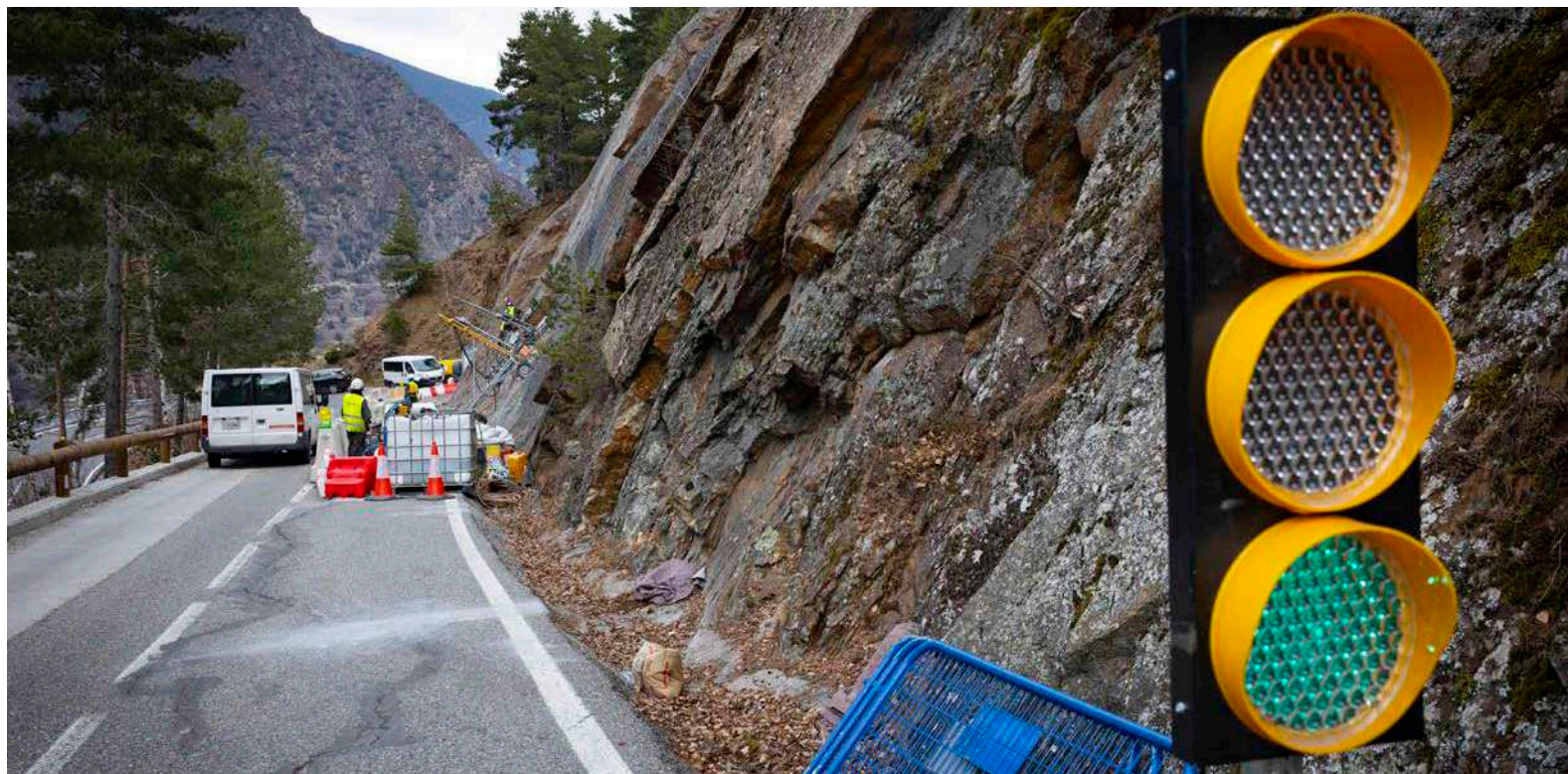
El tram afectat a la carretera de la Comella.
