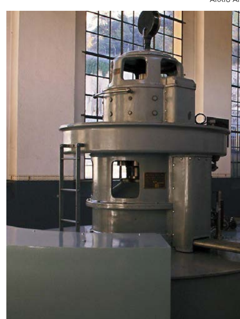
La central hidroelèctrica de FEDA.
