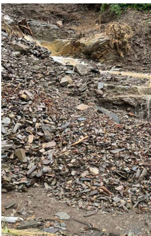
Desperfectes a la carretera de la Rabassa.
