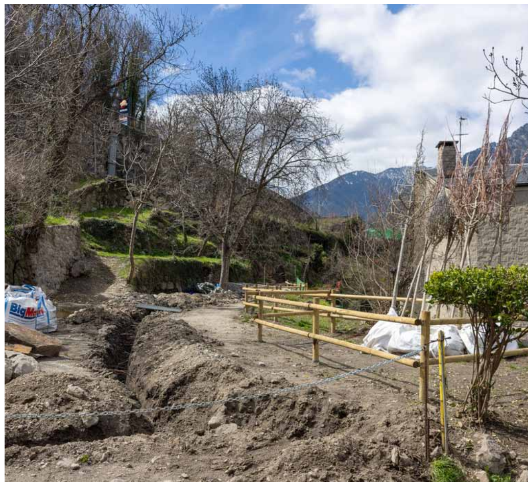
La parcel·la que està adequant actualment el Comú escaldenc a la zona del Barri.
