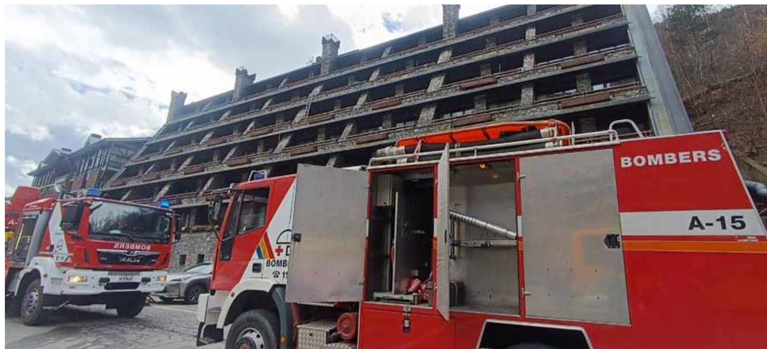
El foc s'ha originat a la sauna de la cinquena planta i ha causat danys per fum i altes temperatures.
