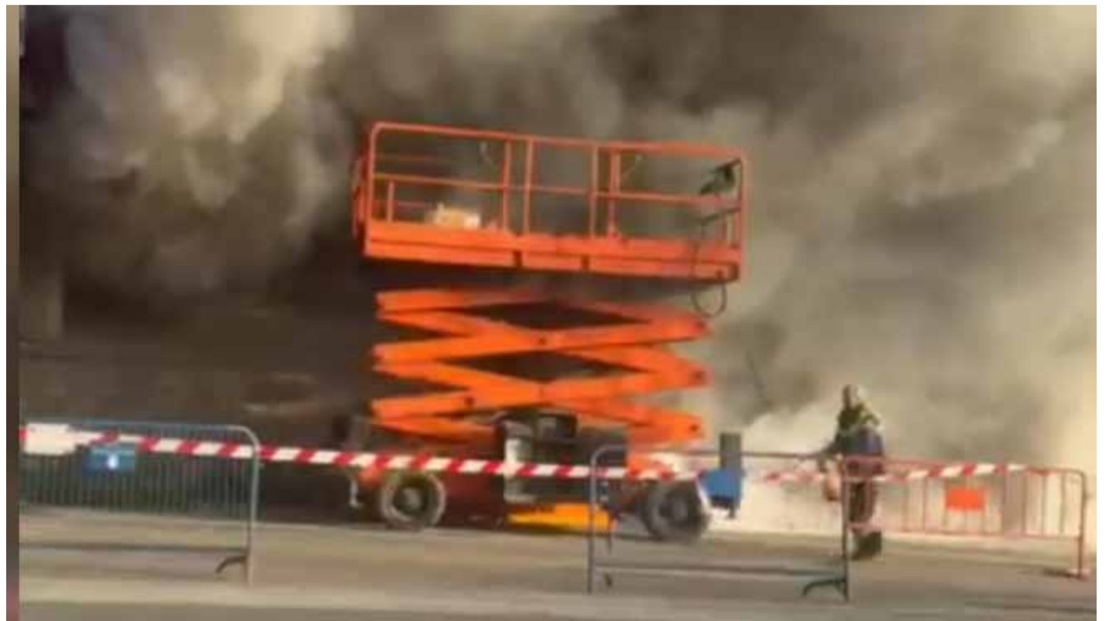
La gran cortina de fum originada pels treballs de soldadura i derivant en el posterior incendi.
