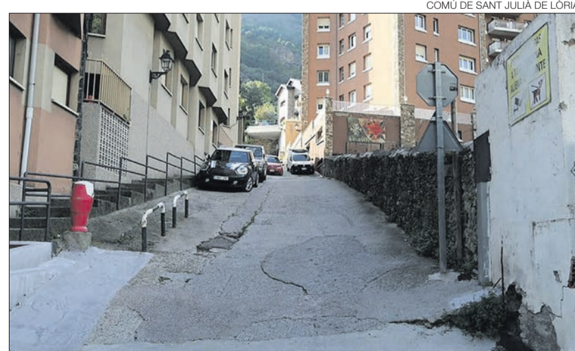
► L'estat actual del pujador dels Fontanals del Pui, a la zona del Solà.
